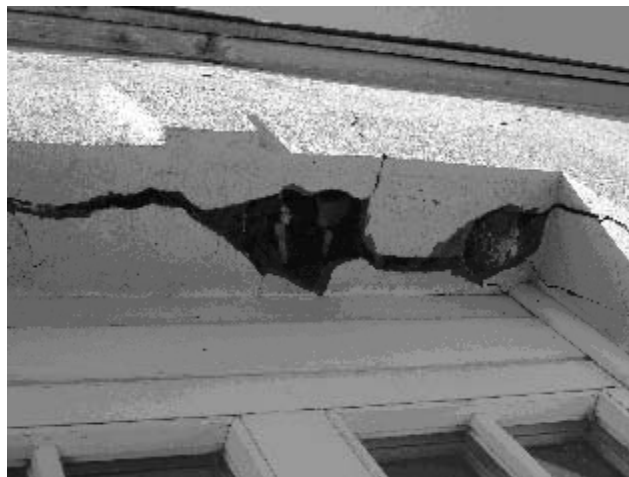
Risse am Gemeindehaus gefährden das Gebäude
